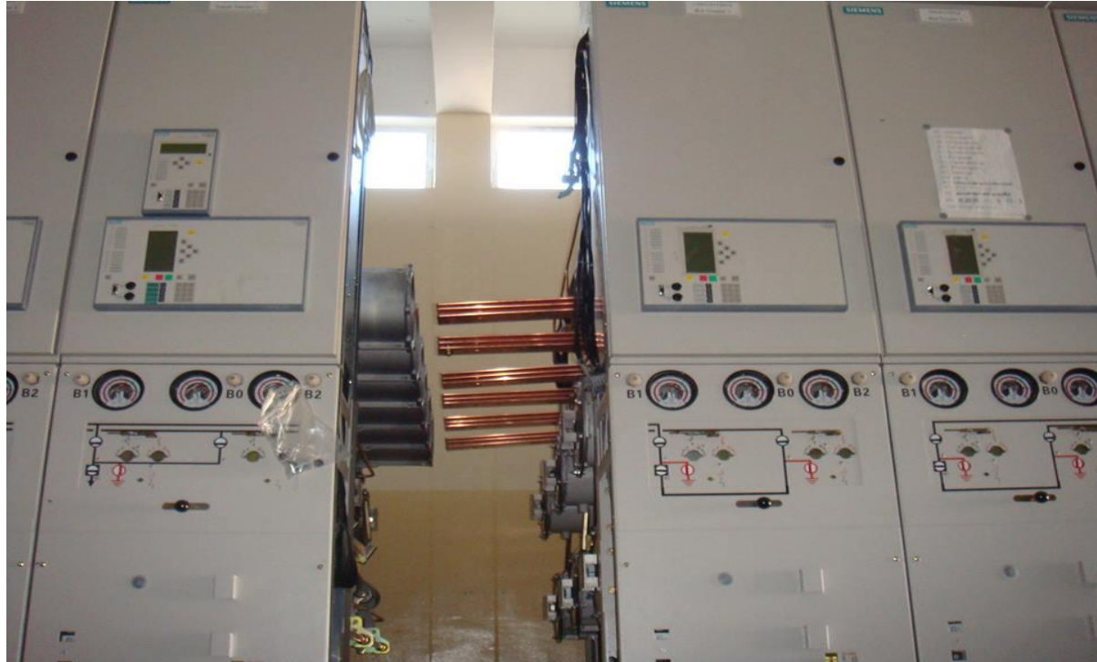
30/11 kv Double B.B, GIS substation(tripoli-libiya)
