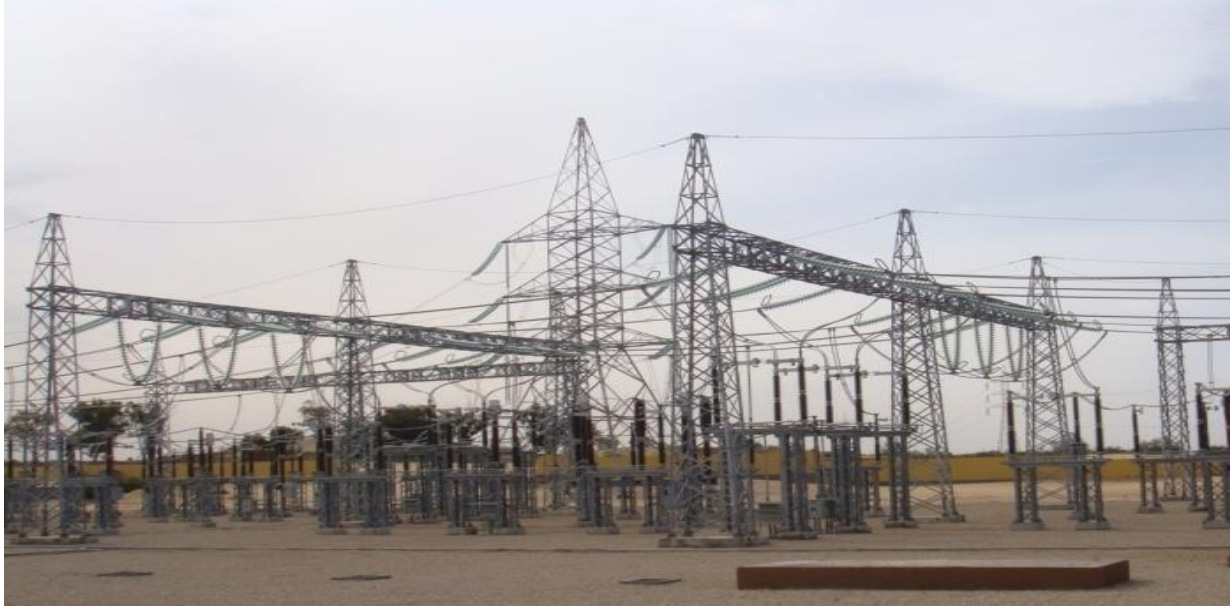
Surman substation 220/30 / 11kv (zawia-libiya)
