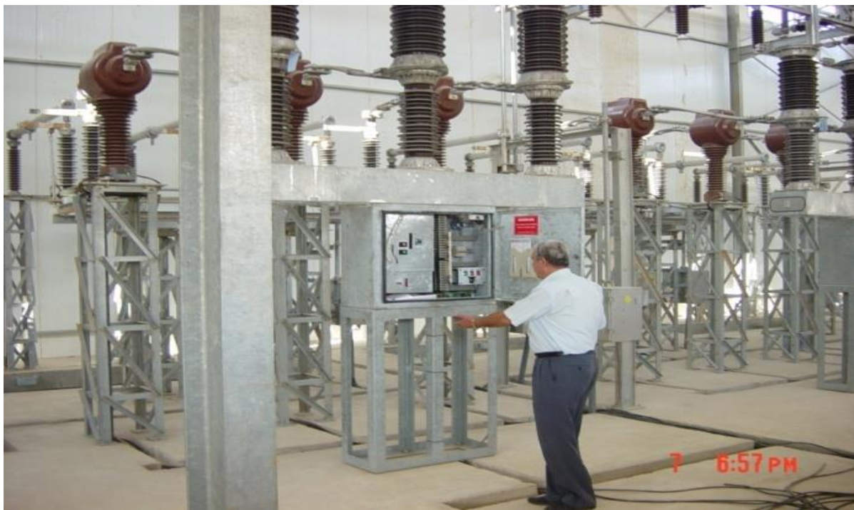
Bir terface substation 220/30 / 11kv (zawia-libiya)
