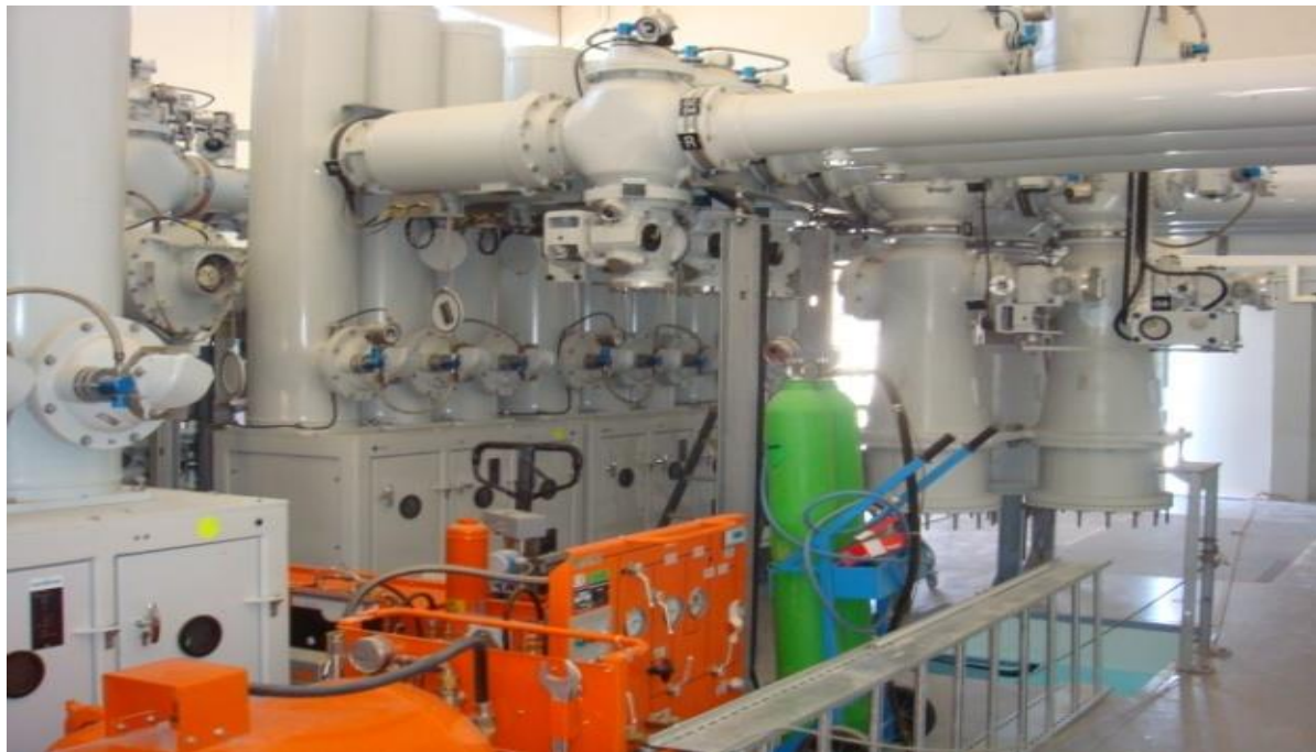
66/11 kv GIS (sirt – libiya)
